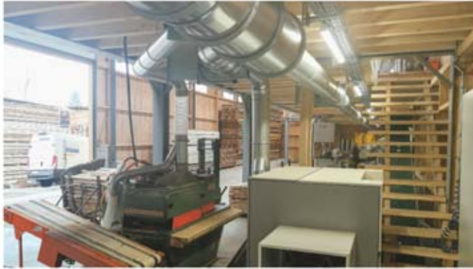
Automatisierte Schiebersteuerungen an sämtlichen Maschinen.
