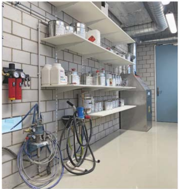
Farbmischraum mit leitfähigem Fussboden.
